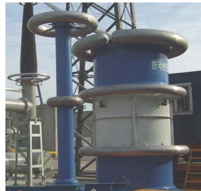
사진 1. 전원장치 Photo 1. Power Supply
