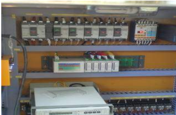
그림 8. 와현가압장에 설치된 스마트 RTU Fig. 8. Smart RTU installed in Wa-hyun Pump Station
