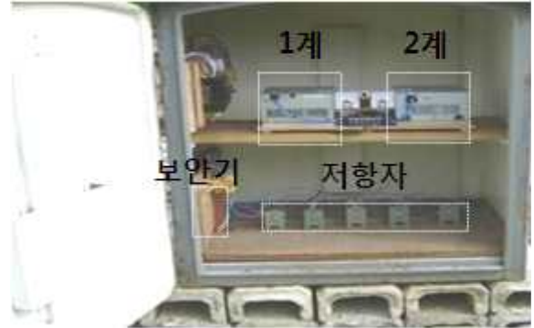
그림 6. 시스템의 현장설치 사진 Fig. 6. Field installation of the experimental system
