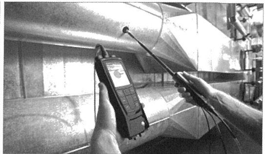
【그림 3】 덕트 내 풍속을 측정중인 Testo 480
