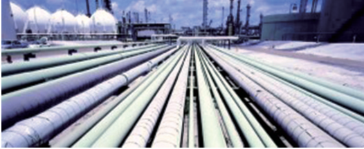
[그림 6] LNG 배관의 외관
