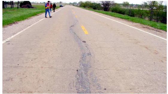
그림 10. 일리노이주 현장방문: 종방향 균열
