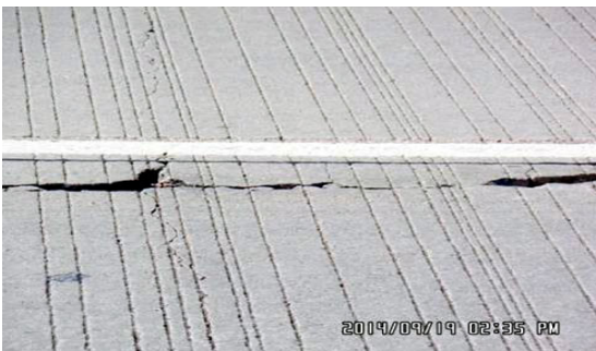
(b) 종방향 균열
