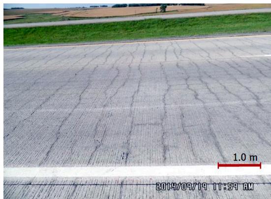
그림 5. 사우스 다코타 현장방문: 횡방향 균열이 발생한 연속 철근콘크리트 포장
