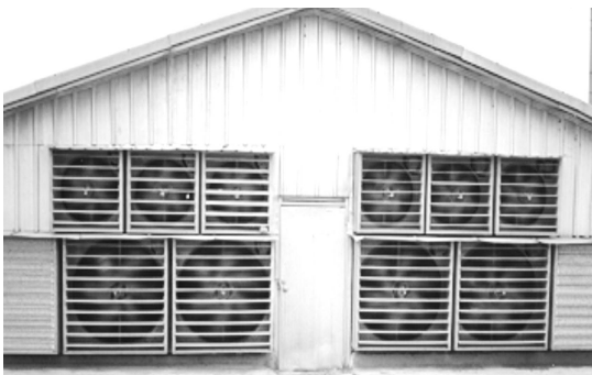
닭장(계사) 환기팬 설치
