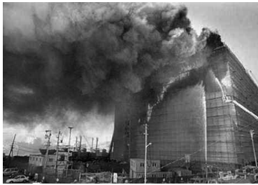
부산 냉동창고 신축공사 화재 (’98.10.29 사망27, 부상16)
