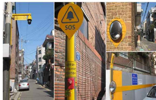
그림 4. 소금길 CCTV와 LED방범등, 반사경, 비상버저 Fig. 4. CCTV & LED Security lighting fixture & Reflector & Emergency Buzzer
